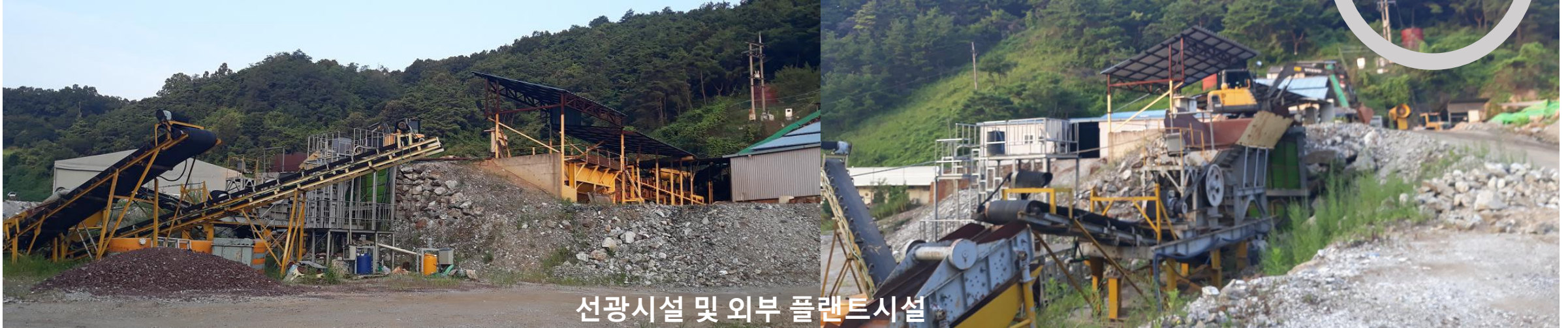
2차선별 및 내부 플랜트시설
